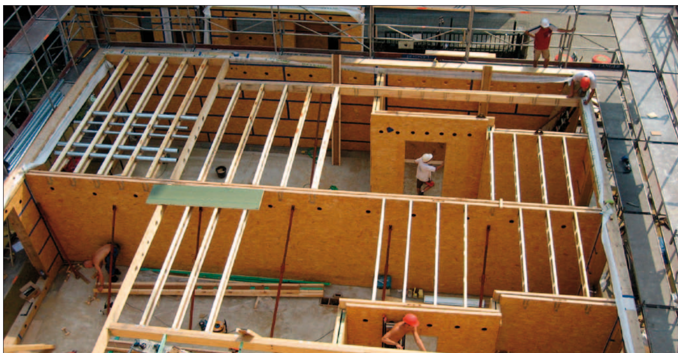
OSSATURE BOIS – La légèreté des structures a permis de limiter l'impact des fondations.
